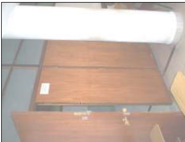
FOTO 7: Abertura Salón G2 (que sea hacia fuera, no hacia adentro por distancia con columna pilar del edificio).
