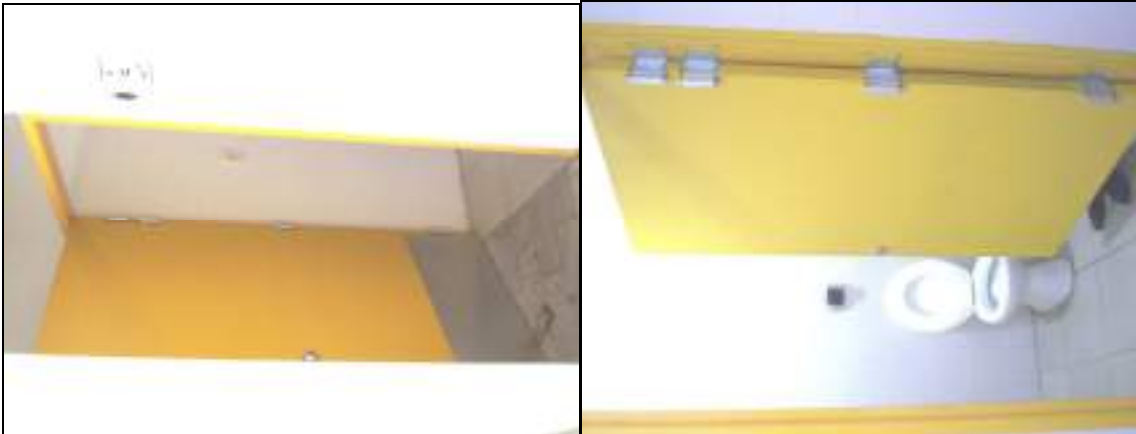
FOTOS 3 y 4: Baños para personas con discapacidad edificio nuevo inaccesibles por cómo está colocada la abertura de la puerta (hacia fuera) y faltan accesorios necesarios para el apoyo y reubicar el water.
